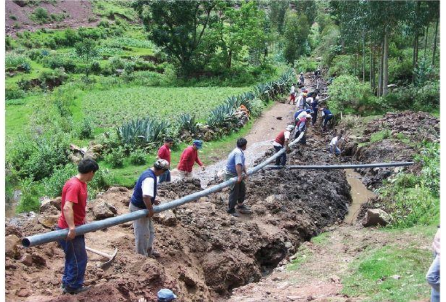
Peru'da bulunan Tipon yerleşmesinde köylülerin imece usulü ile su yolu yapım çalışmaları
